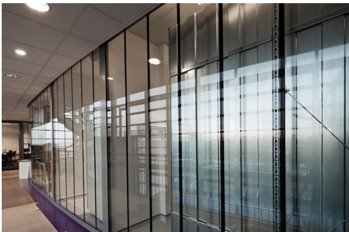
De gesegmenteerde pui van het glazen ei is 60 minuten brandwerend. De bovenbevestiging is achter het verlaagd plafond weggewerkt. Foto: Hennie Raaymakers/DAPH
