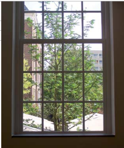
Er is een rustig en onopvallend gevelbeeld bereikt door alle beschermcaps van het vacuümglas in dezelfde hoek te zetten. Foto: Rik Vollebregt
